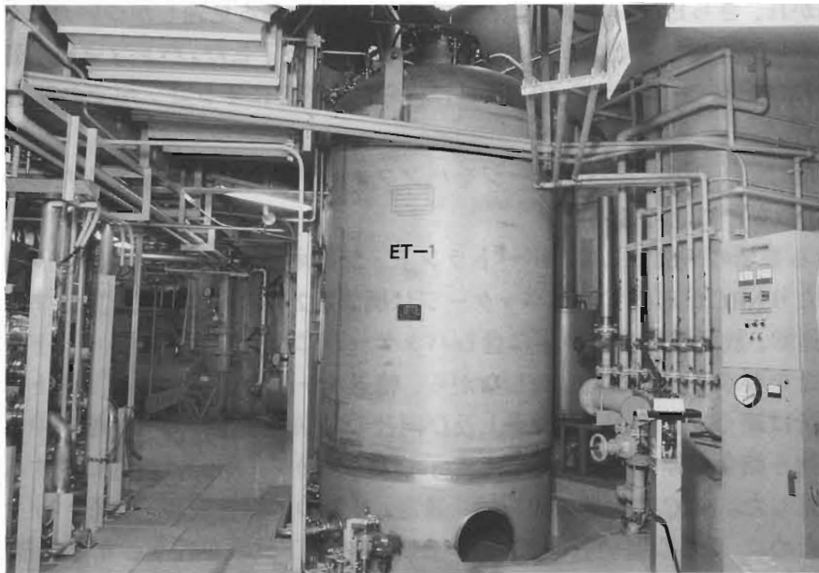
整備の終了した重水保管設備
